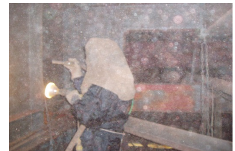
研削材粉砕による粉じんの様子 → 作業員の視界が悪い
