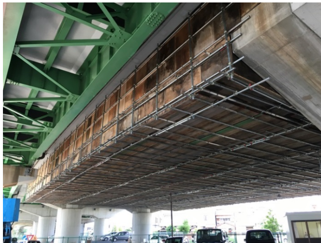
板張防護設備の外観
